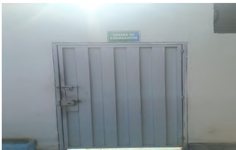
Ilustración 1-12. salida de emergencia
